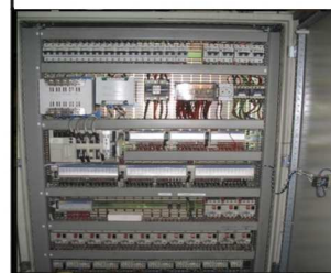
Armoire de commande avec automate
